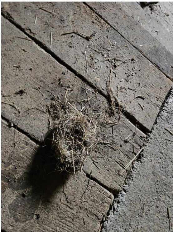
Abbildung 12: Altes, heruntergefallenes Vogelnest in der Scheune
