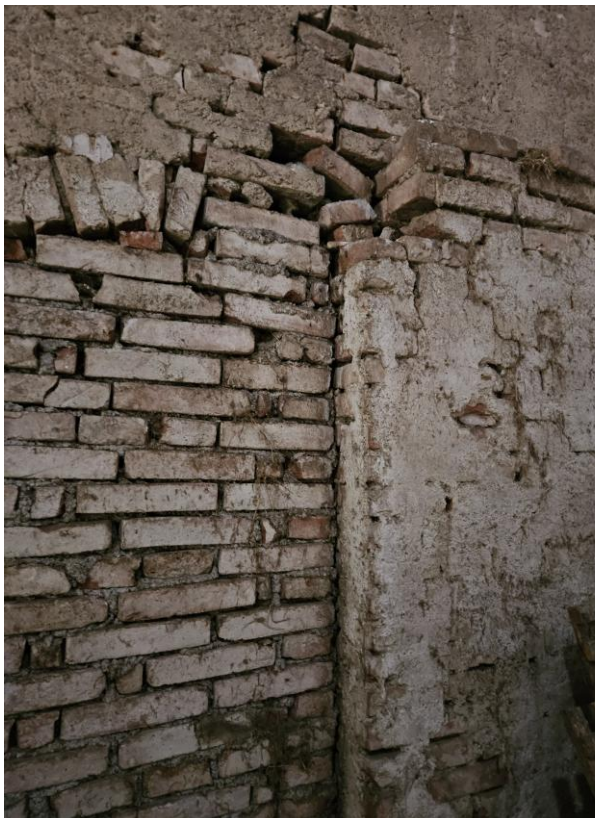
Abbildung 10: Spalten im Mauerwerk der Scheune
